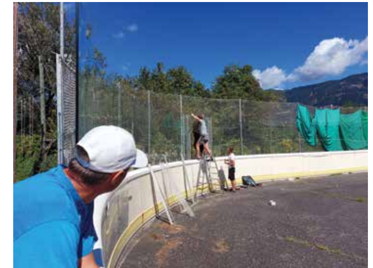
Foto: Der Einbau von riesigen, schlagfesten Glasscheiben war noch einmal ein Kraftakt
