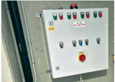
Foto: Schaltkasten für die Steuerung
