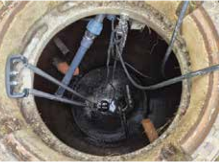
Foto: Eine Pumpe im Nachklärbecken
