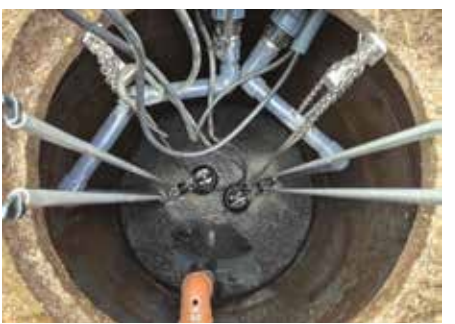
Foto: Zwei Pumpen im Pumpschacht
